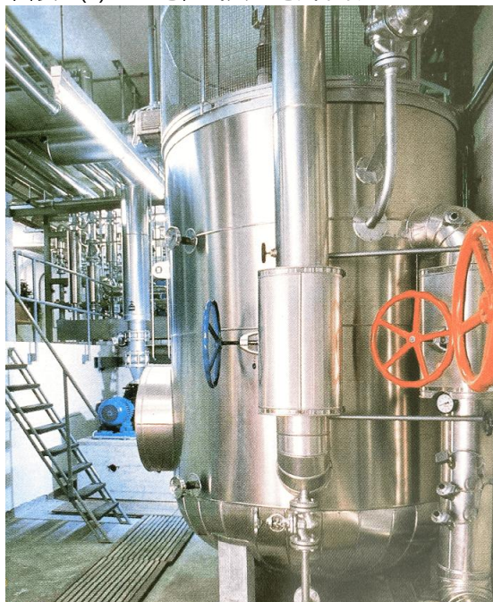
図表2-(5)-5. 電極式大型電気ボイラー
